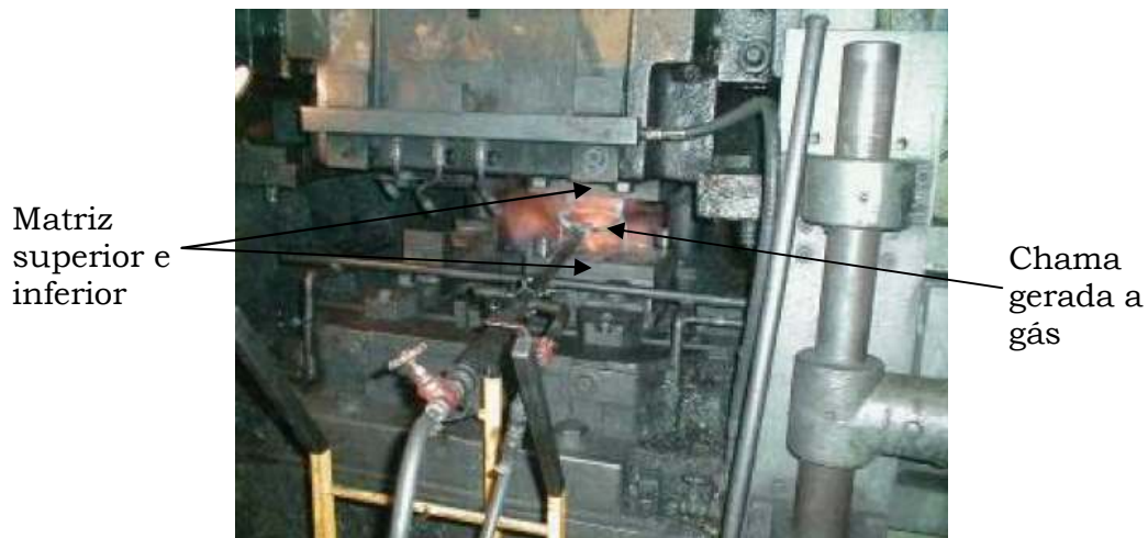
Figura 1-1: Sistema de aquecimento manual
