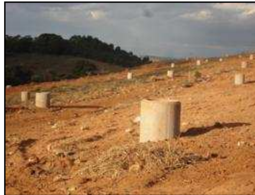
Rede de dreno de gases em aterro sanitário
