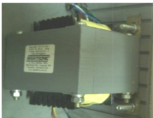
Figura 24 - Transformador do circuito de elevação de tensão
